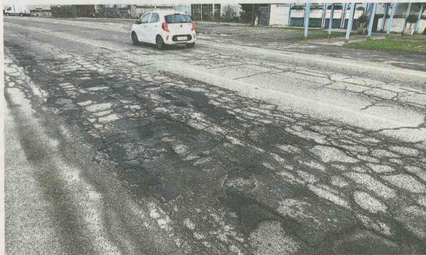
L'asfalto rovinato lungo la ex statale 494 nel tratto tra il centro commerciale "Il Ducale" e la rotonda di Moreschi (foto Ferruccio Sacchiero)
