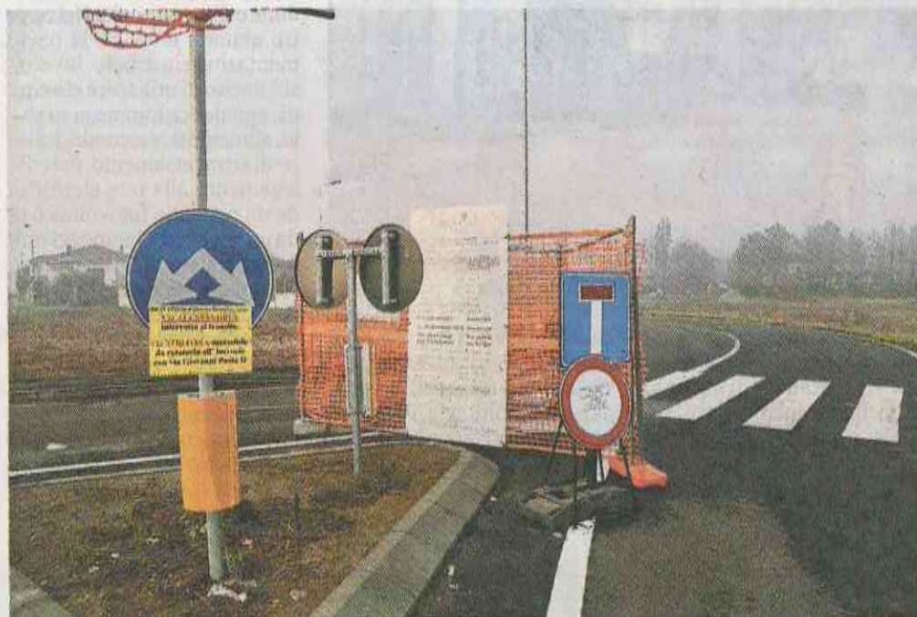
Il cantiere nella zona di corso Novara: lavori pagati dal market Tigros che ha aperto nella zona
