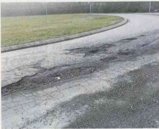
» Le voragini si sono aperte in prossimità delle rotonde Qui, sull'ex statale 494. Un pericolo per chi circola
